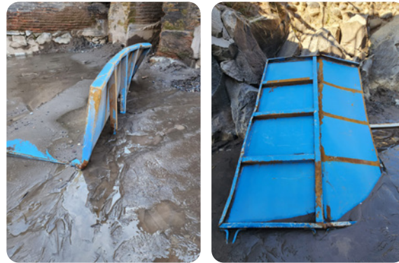
Compuertas destruidas en Bocatoma Eyzaguirre
