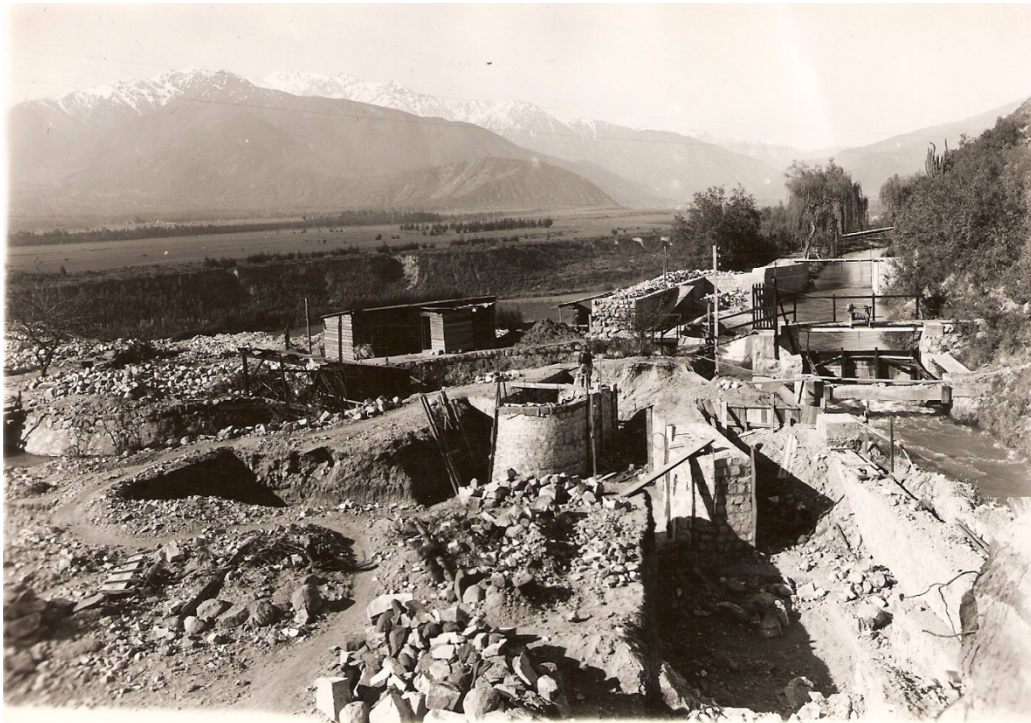
Muros, compuertas y vertederos para la entrada del agua para el nuevo desarenador, a la derecha el actual canal, Septiembre 1942
