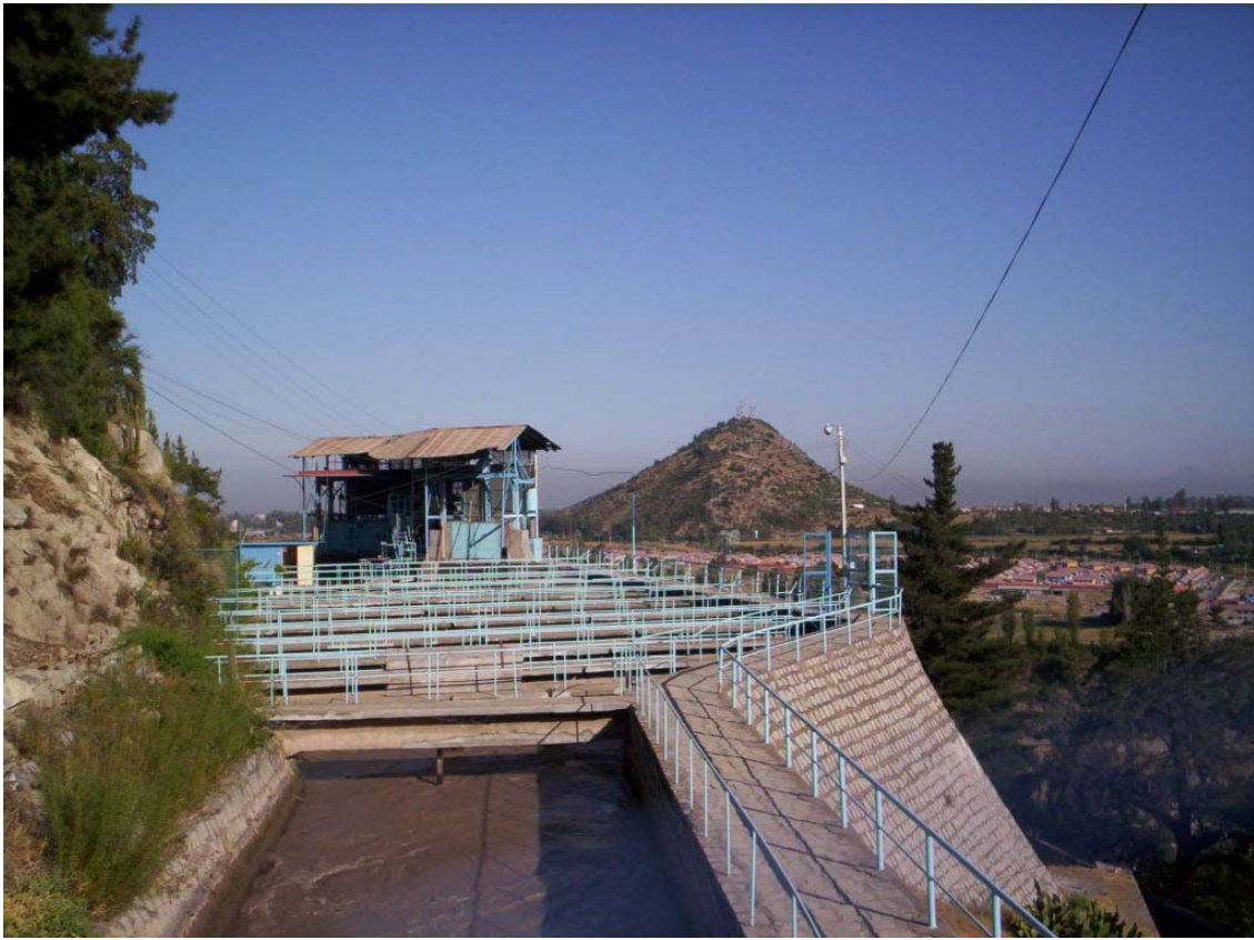
Vista de cámara de carga
