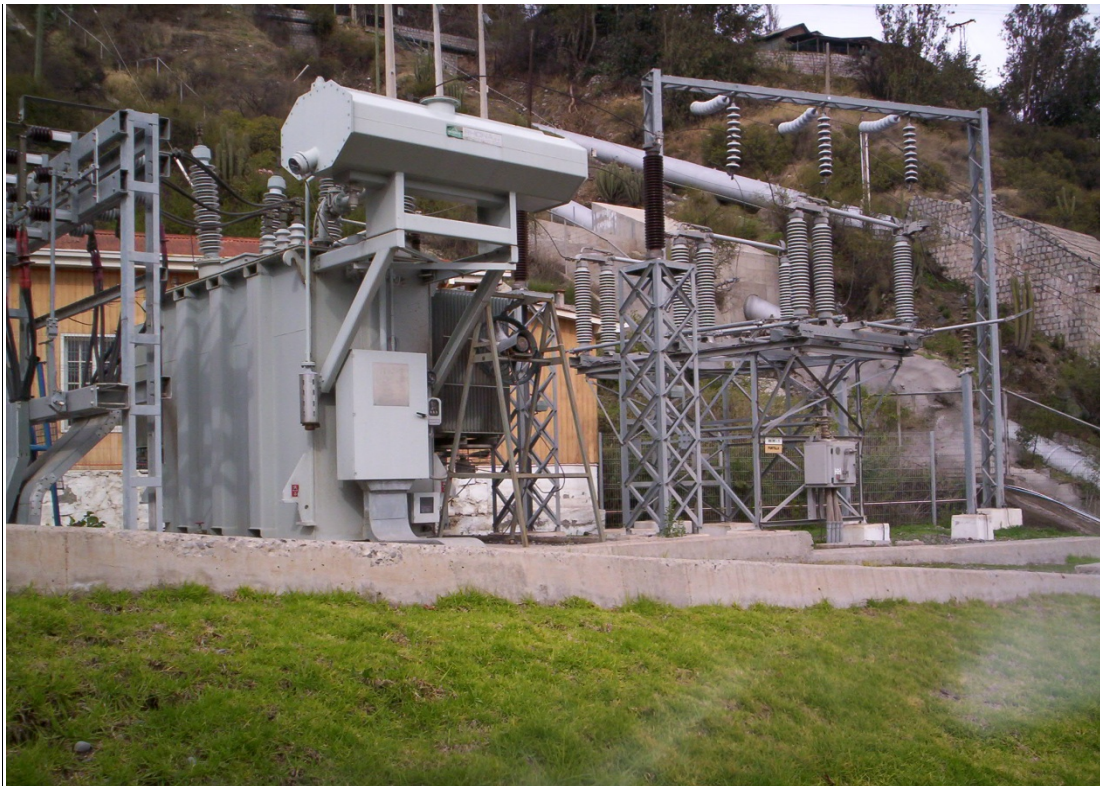
Subestación de poder de 12-16-20 MVA - 6,6/110KV
