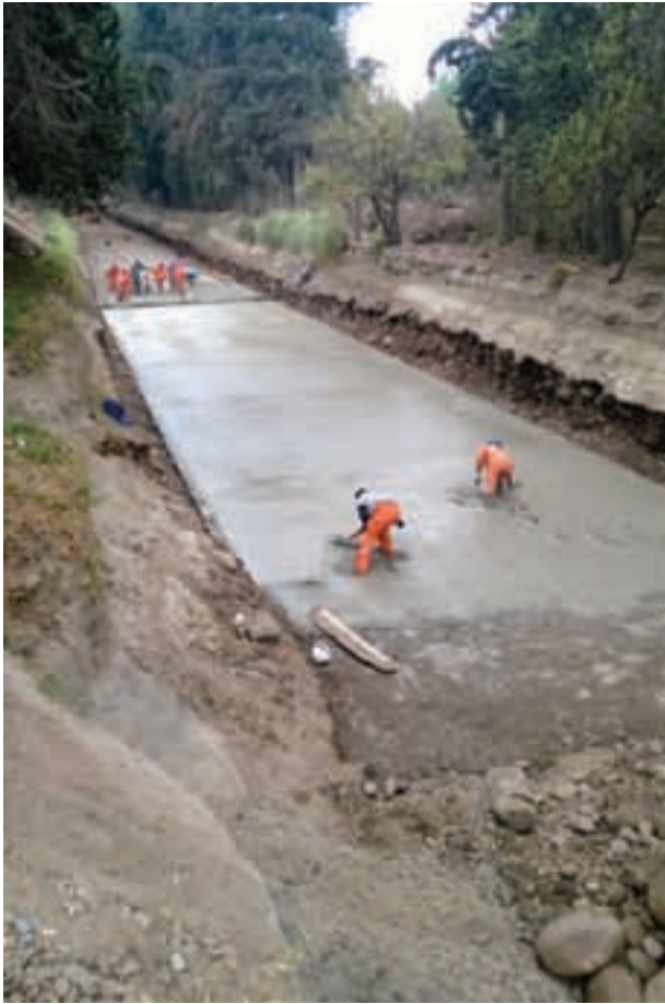
Radier Canal Florida.
