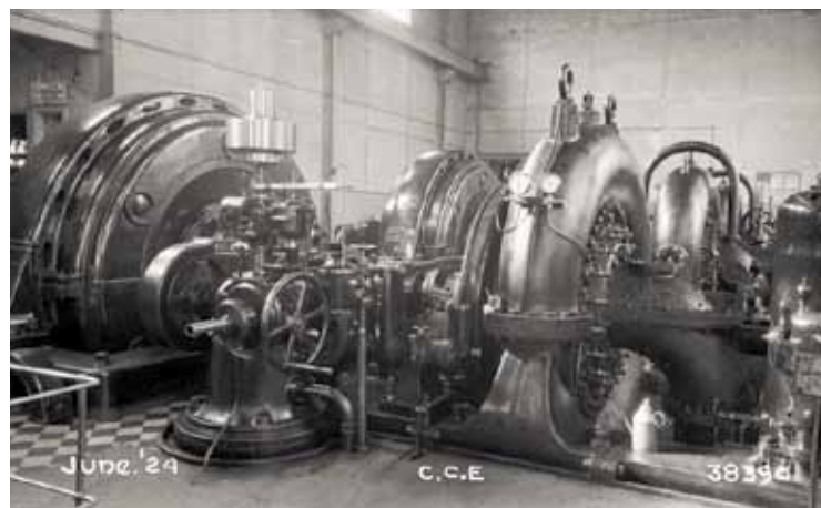
Sala de máquinas
