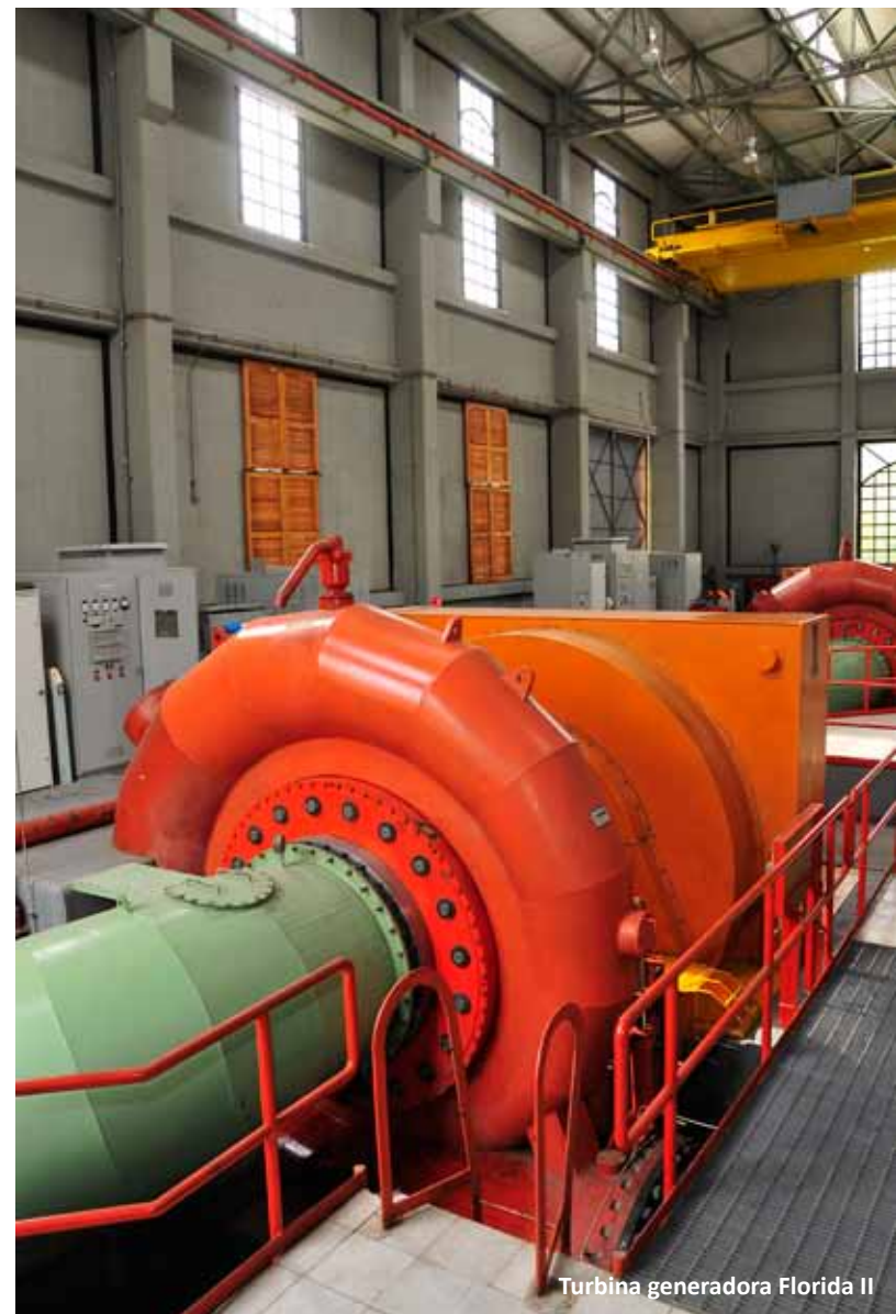
Sala de máquinas Florida II
